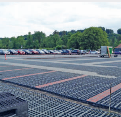
Einsetzen der TTE® Pflastersteine in die TTE® Bauelemente als Stellplatzmarkierung und Gehweg
