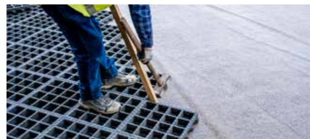
Auf enge Verlegung und regelmäßiges Nachklopfen achten, um eine spätere Fugenbildung zu verhindern.
